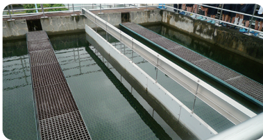
薬品沈でん池
