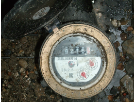
水道メーター
